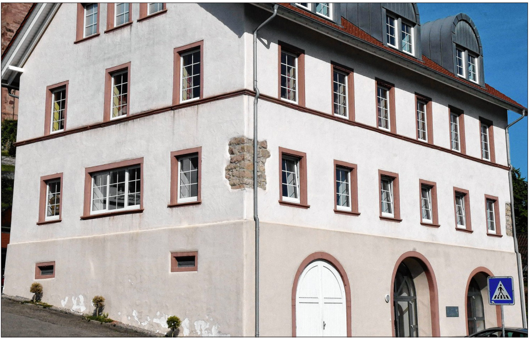
Am Vereinshaus Alte Schule Waldulm zeigen sich Fassadenschäden. Der Ortschaftsrat nahm ihre Ausbesserung auf den Haushaltsplan 2024.
